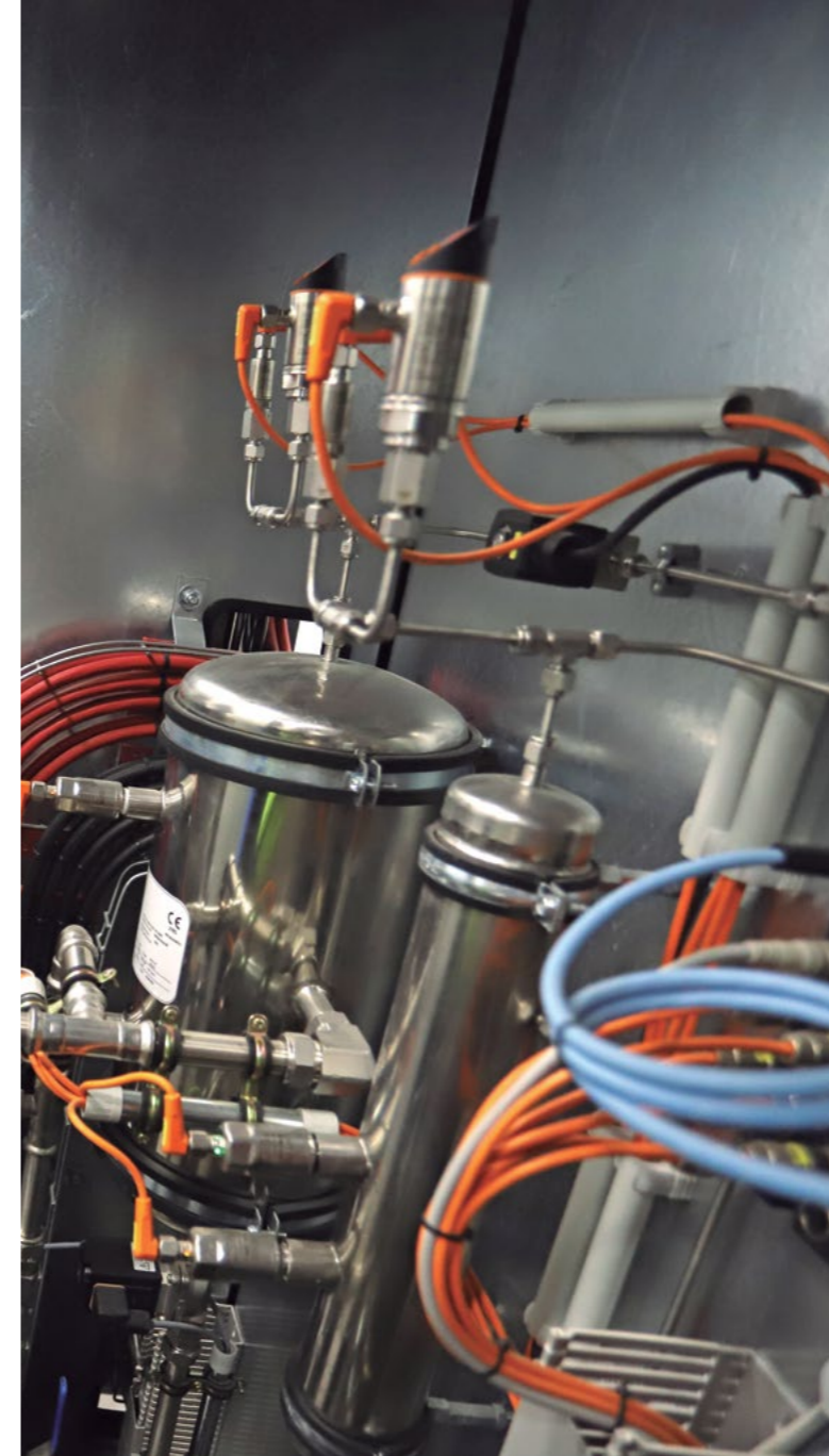
Tecnologia de última geração e maior automação no monitoramento trazem mais segurança e agilidade para a operação.
